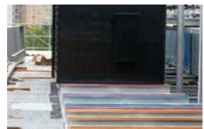
Bild 1: Underhållsfri uppställning med Isotop DSD
