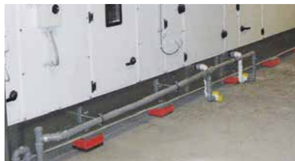
Bild 1 (ovan): Sylomer® för ett takmonterat AC-system
